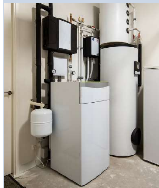
Ejemplo de una bomba de calefacción - Instalación interior
